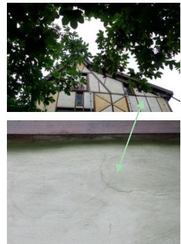
Surélévation d'un pavillon de banlieue parisienne. Fissure d'un enduit.
