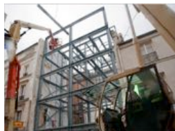
Projet rue Myrha de NXNW architecte et LM ingénieur. Crédit photo : Fabrice Malzieu.
