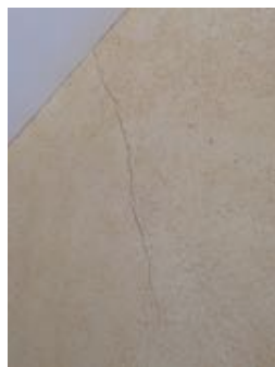
Microfissuration d'un enduit.
