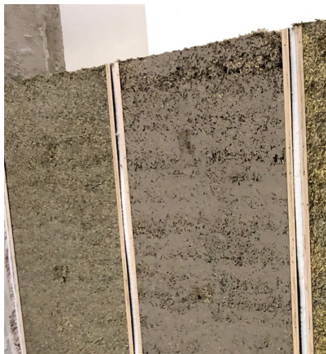
Photo 3 : béton de chanvre homogène sur sa surface.
