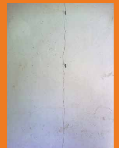
Fissuration au droit d'un poteau
